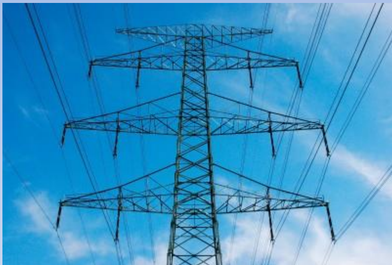
Sloup přenosového vedení
